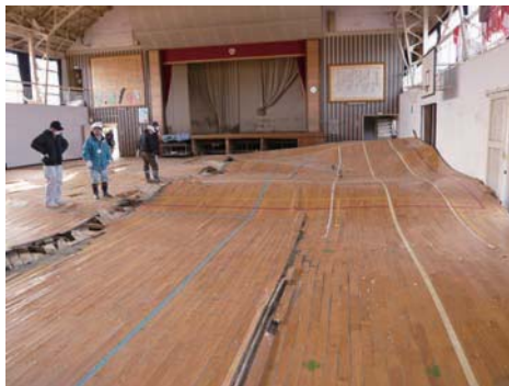
地震と津波により体育館の建物が歪み、床が波打っている
