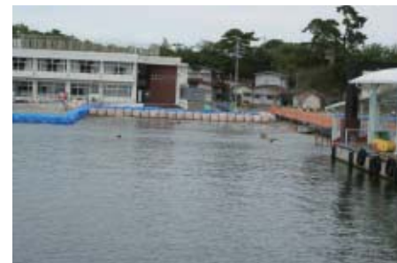
地盤沈下による冠水
