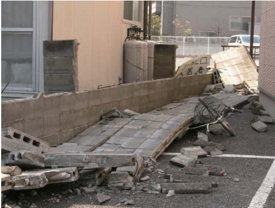
組積造塀被害例 1
