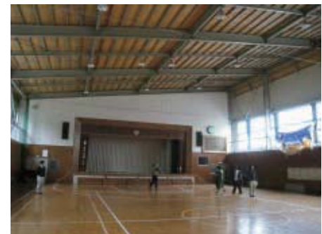
屋内運動場の被害調査の様子（陸前高田市）
