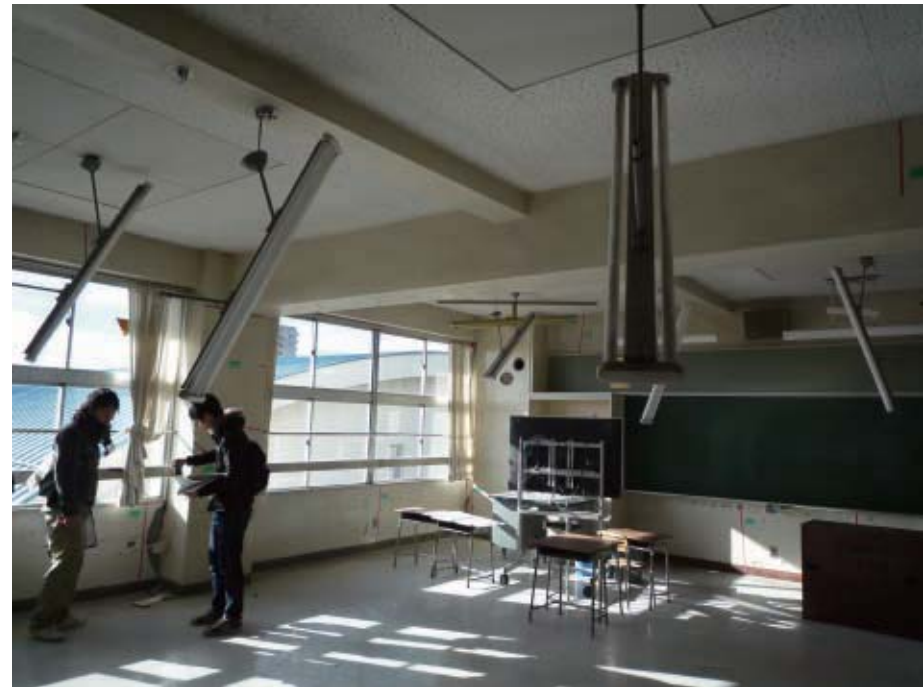
教室の被害状況の調査（仙台市内）
