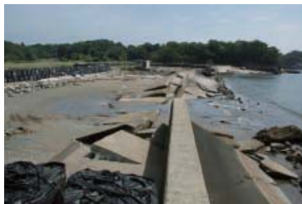
野々島防波堤被害
