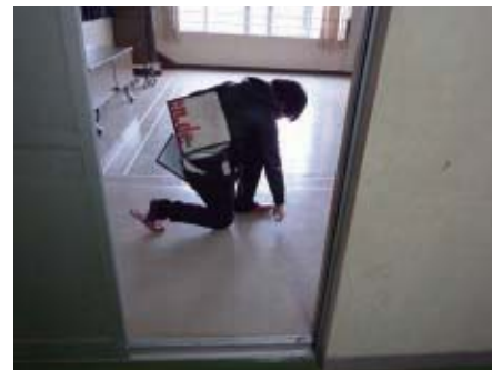
床のひび割れ幅のチェック（仙台市内）
