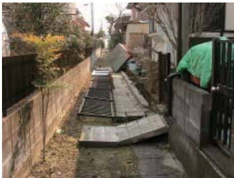
組積造塀被害例 2
