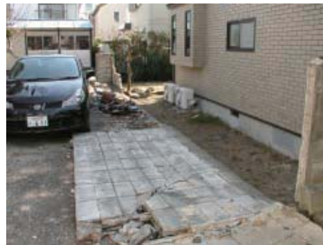
組積造塀被害例 3
