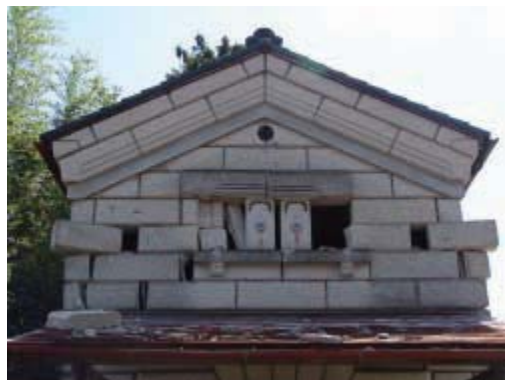
地震で被害を受けた石蔵
