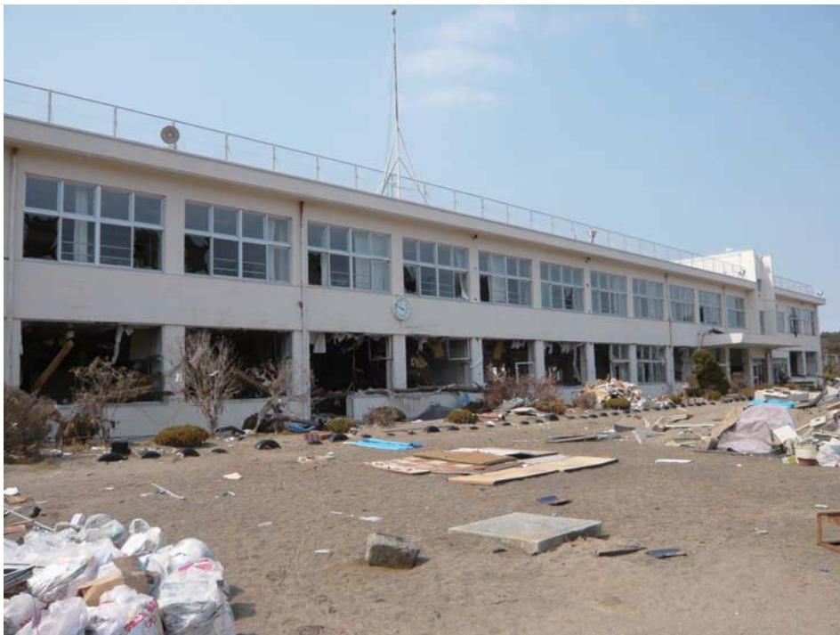
1階に津波被害を受けた中学校校舎
