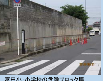
富田小:小学校の危険ブロック塀
